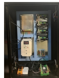
CABINA CON PANNELLO DI ELETTRICITA'
