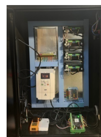
CABINA CON PANNELLO DI ELETTRICITA'
