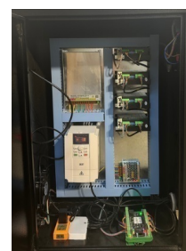
CABINA CON PANNELLO DI ELETTRICITA'
