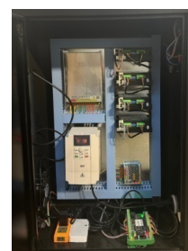
CABINA CON PANNELLO DI ELETTRICITA'
